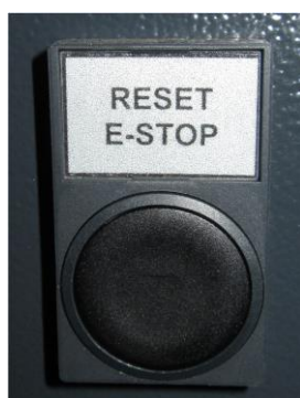
Reset na rozvaděči
